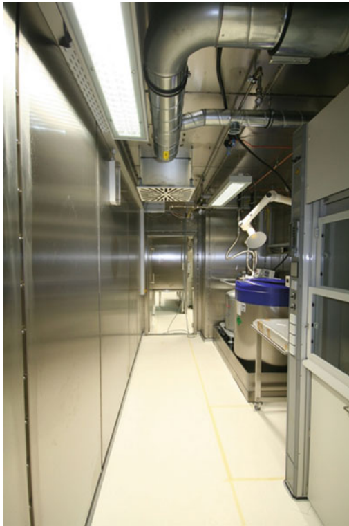
Abb. 3 Großgeräteraum im BSL-4-Labor mit Flüssigstickstofflagerbehälter (Fa. Cryotherm)
